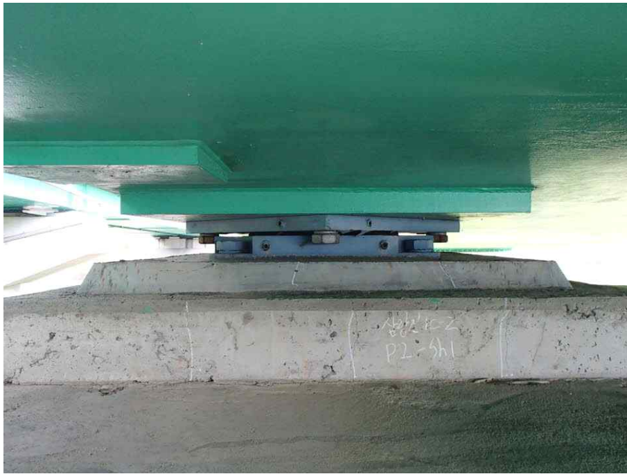
반침장치 전경 (고정단)
